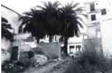
El estado del edificio de calle Ollerías antes de iniciar el proyecto era ruinoso.
